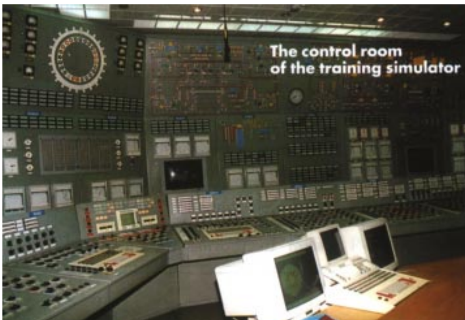
Bild 4: Schaltwarte des Trainingssimulators.
